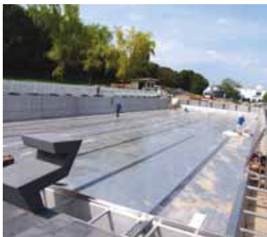
Bereits mit Edelstahl ausgekleidet ist u.a. das Schwimmerbecken des Rheinhesen-Bades.
