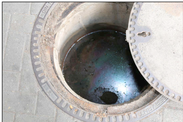
Foto 3 (links): Völlig zugesetzter Schlammfang auf der Hoffläche des Grundstücks Am Becherweg 2. Zum Auffangen von Grobschmutz wurde unter die Einleitstelle ein Eimer untergestellt.
